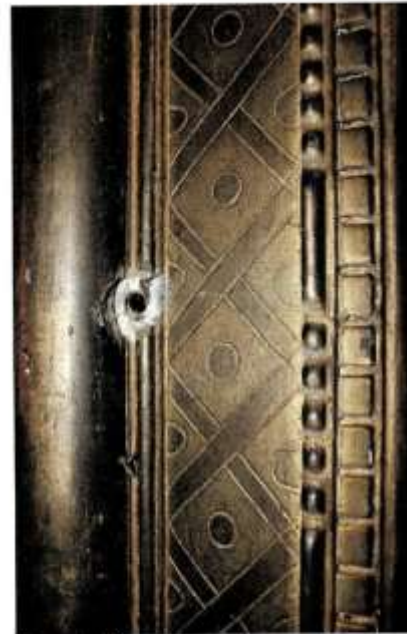
Trous de fixation et pointes en façade
