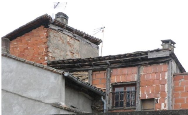
Exemple de restauration de pans de bois à proscrire (1-6-7.c) : remplissage du pan de bois avec des matériaux non adaptés et masquage des pans de bois avec un enduit ciment.
