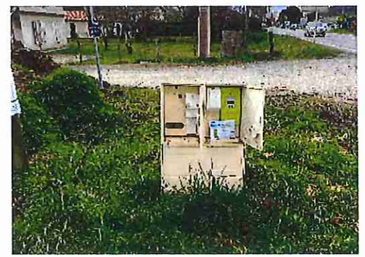
COMPTEUR DISJONCTEUR EXISTANT RECUPERER
